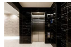
エレベーター
